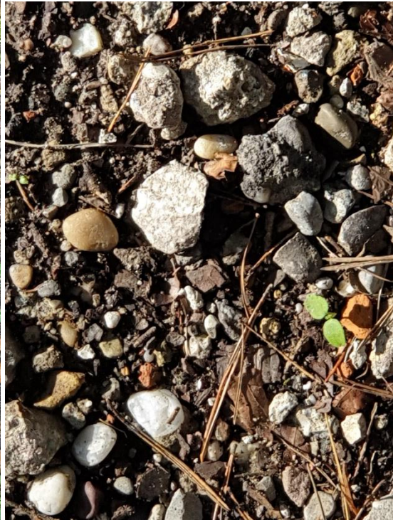
Abb. 15: eingebauter Bauschutt im Forstweg
